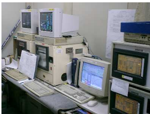
管理室内 ユニット操作盤設置状況
